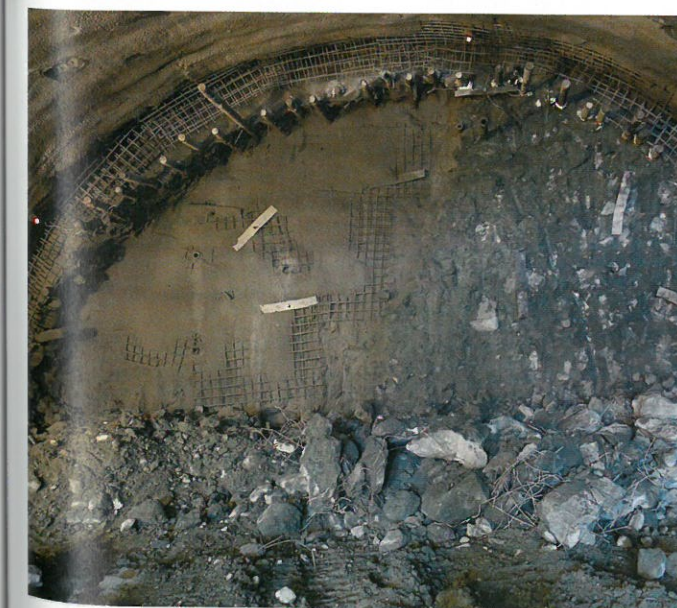
STUFF: Slik ble det sikret for at stuffen ikke skulle rase ut inne i løsmassetunnelen. Foto: Margrete Øie Langåker/Sweco.
